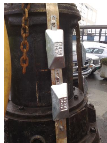
Pumpe med sink-offeranoder for å begrense korrosjon
